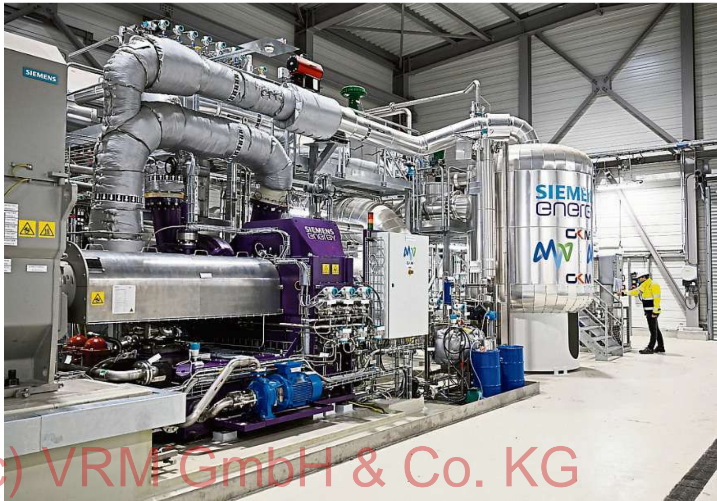
Ein Mitarbeiter steht auf dem Gelände des Großkraftwerks Mannheim an einer Flusswärmepumpe.
